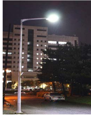
군산시청 기존 등주에 LED램프만 교체-120W
